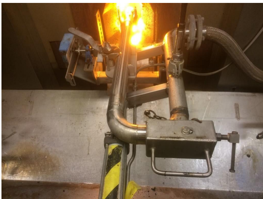
Bild 6 Fast spruta med en skyddande handske med låssprint över flänskopplingen. Anslutande slang för lut är fast monterad för minimal påverkan och slitage på slang i samband med sprutbyte. Operatören är skyddad mot eventuellt läckage i anslutningen mellan böj och lutsprutan.
