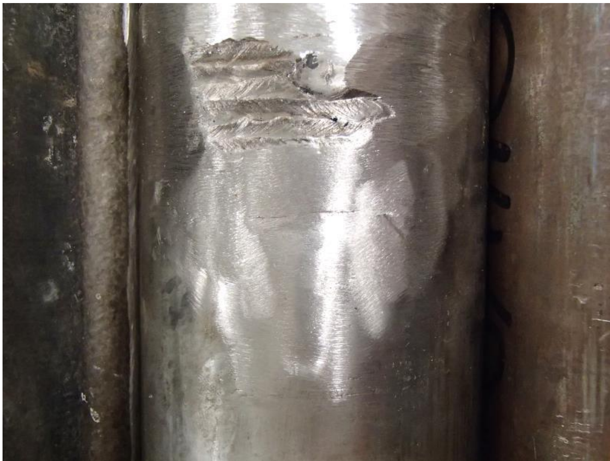
Figur 5. Ett annat exempel där man valt att slipa påsvetsningen ännu mer jämn, men ändå behållit en oslipad del för att underlätta framtida av lokaliseringsmöjligheter.
