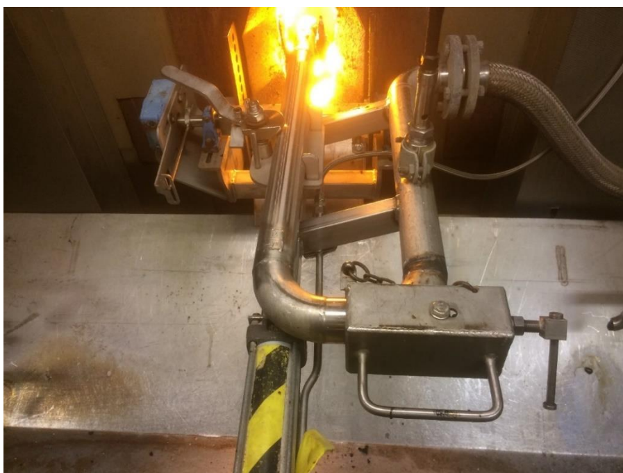
Bild 6 Fast spruta med en skyddande handske med låssprint över flänskopplingen. Anslutande slang för lut är fast monterad för minimal påverkan och slitage på slang i samband med sprutbyte. Operatören är skyddad mot eventuellt läckage i anslutningen mellan böj och lutsprutan.
