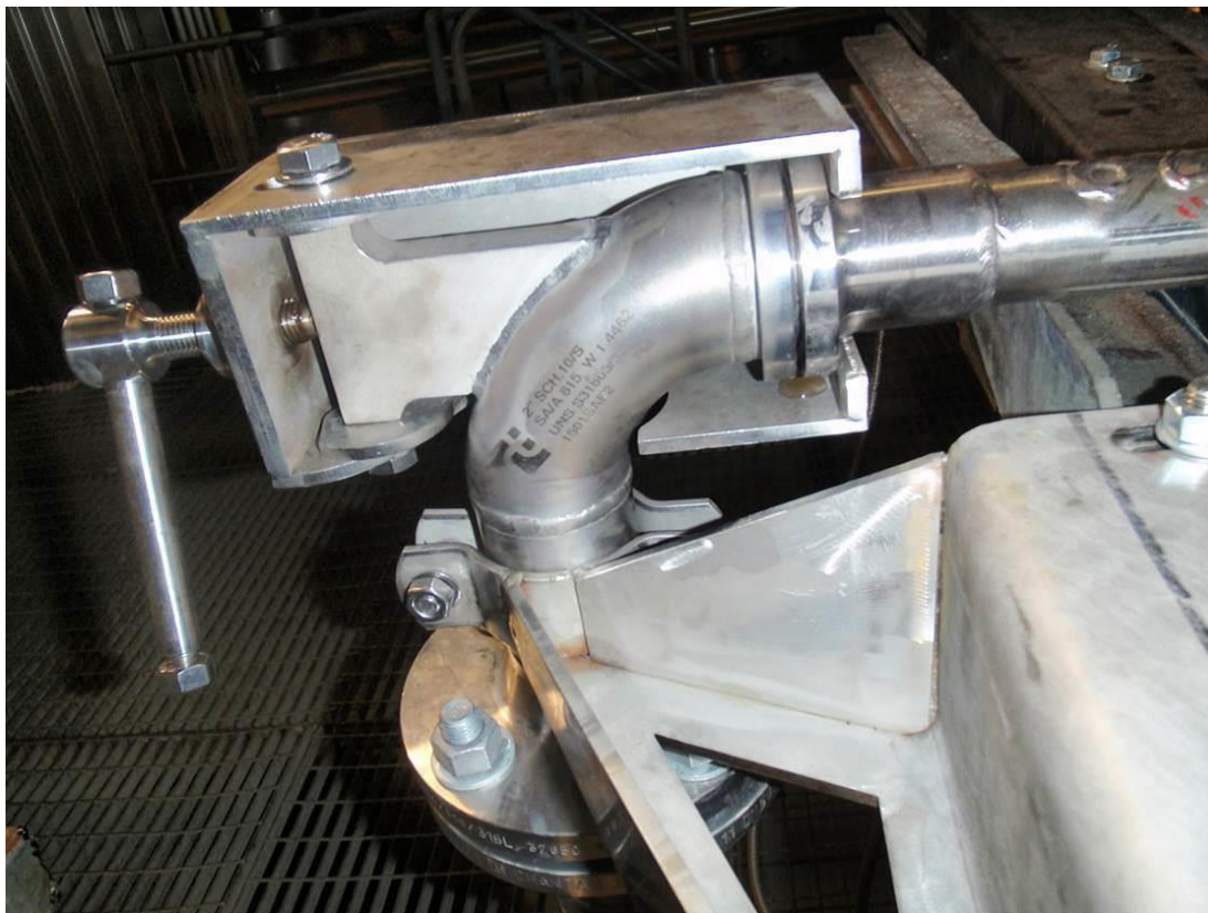
Bild 3 Operatören är skyddad mot eventuellt läckage i anslutningen mellan rörböjen och lutsprutan. Eventuellt kvarvarande tryck kan säkert evakueras genom att kopplingen lösgörs på ett kontrollerat sätt genom att den gängade stängeln försiktigt lossas.
