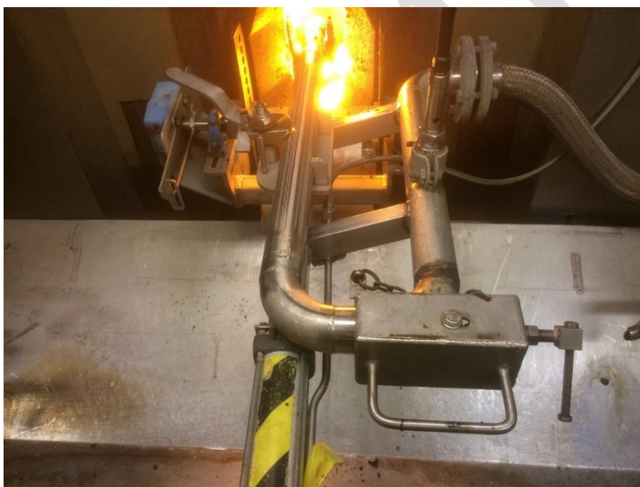
Bild 6 Fast spruta med en skyddande handske med låssprint över flänskopplingen. Anslutande slang för lut är fast monterad för minimal påverkan och slitage på slang i samband med sprutbyte. Operatören är skyddad mot eventuell läckage i anslutningen mellan böj och lutsprutan.
