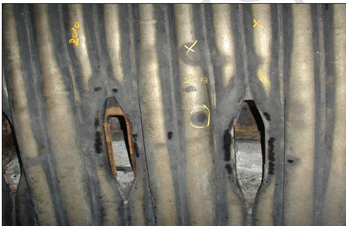
Fig. 5. Missfärgade områden (svart yta) på det rostfria skiktet som kräver tubbyte på grund av risk för vattensidig korrosion.
