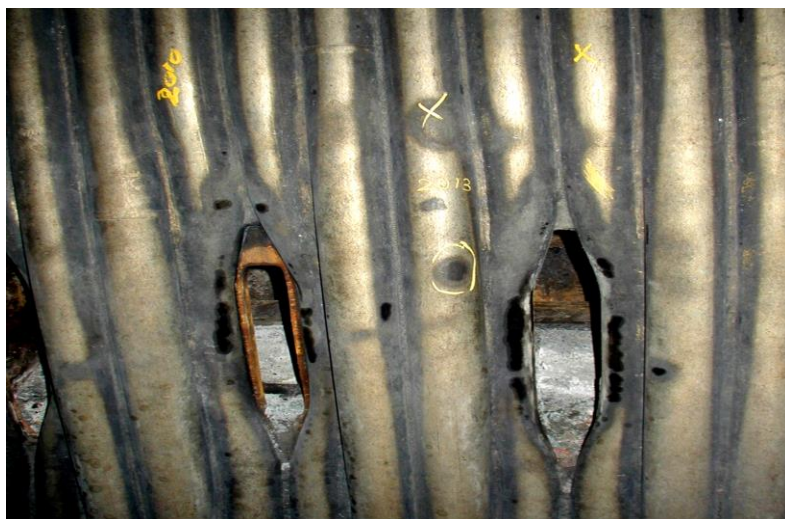
Fig. 2: Missfärgade rostfria ytor som kräver tubbyte pga. risk för vattensidig korrosion
