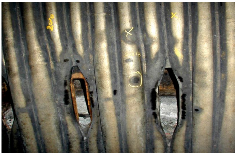
Fig.4: Missfärgade rostfria ytor som kräver tubbyte pga. risk för vattensidig korrosion
