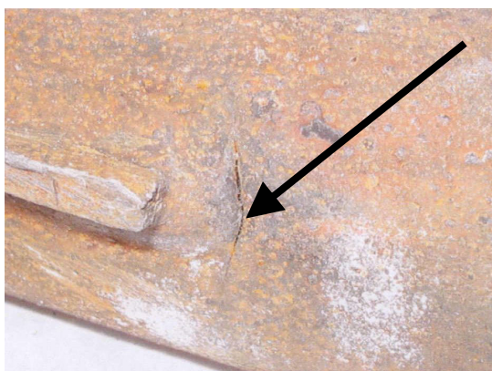
Gruvön SP5, sprickor i änden av membran
