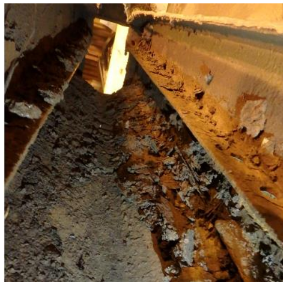
Figur 7 Beläggningar inuti löpränna efter drift på Husum TP6 som har mekaniskt renat kylvatten.
