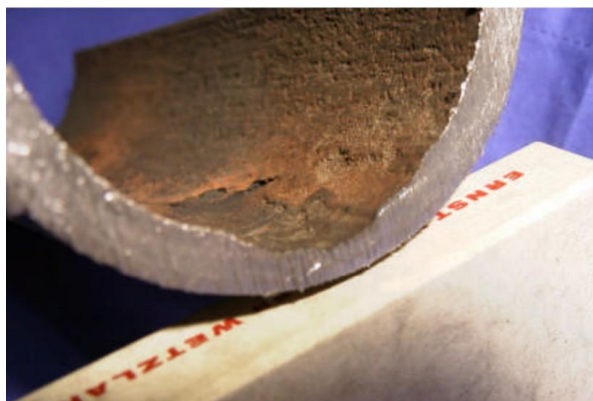
Bild 6: Exempel på korrosionsangreppet vid hetvattenoxidation. Skada 2001-13.
