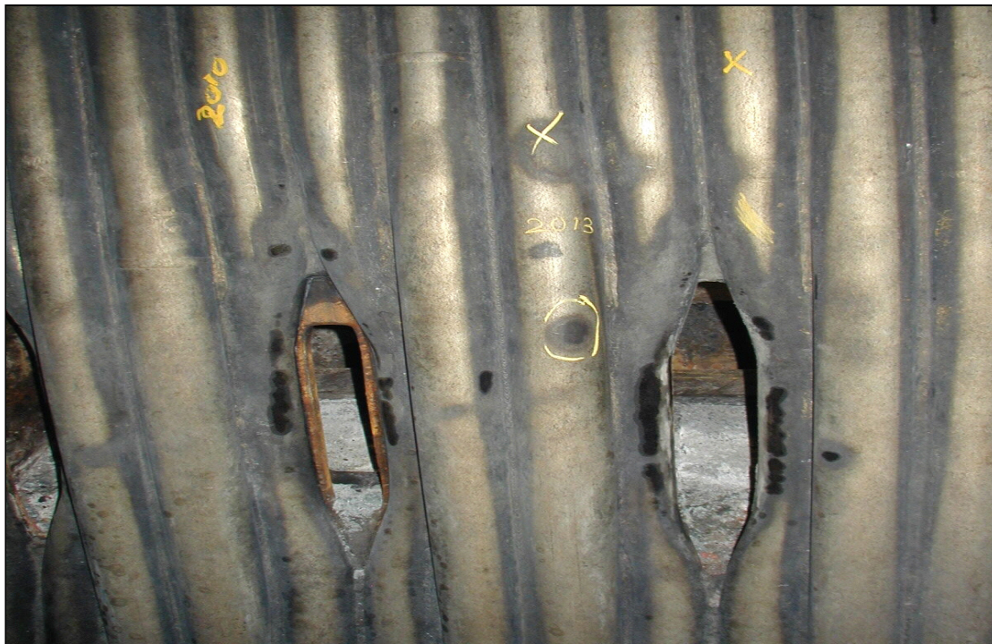
Fig. 1. Missfärgade områden (svart yta) på det rostfria skiktet som kräver tubbyte på grund av risk för vattensidig korrosion.
