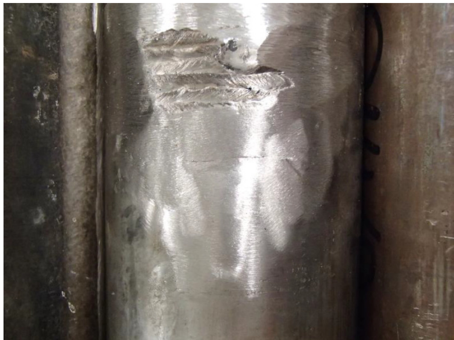
Figur 4. Ett annat exempel där man valt att slipa påsvetsningen ännu mer jämn, men ändå behållit en oslipad del för att underlätta framtida av lokaliseringsmöjligheter.
