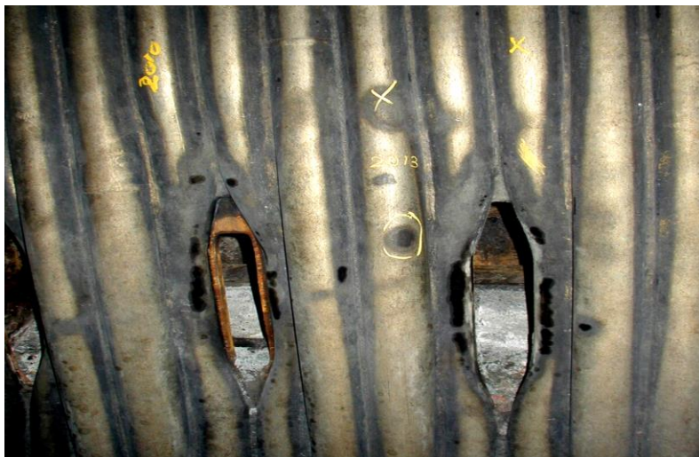
Fig.4: Missfärgade rostfria ytor som kräver tubbyte pga. risk för vattensidig korrosion
